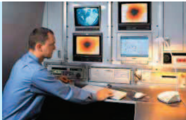
Wnętrze specjalistycznego samochodu do teleinspekcji kanałów (fot. arch. PWiK Dąbrowa Górnicza)
