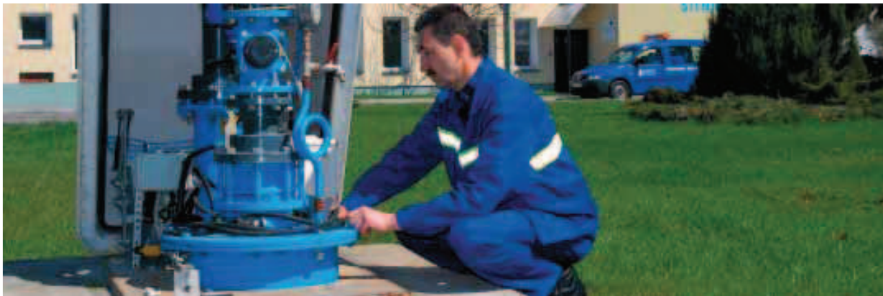
Studnia głębinowa – Stacja Uzdatniania Wody Sitnicka – Biała Podlaska. (fot. M. Kucharczyk)
