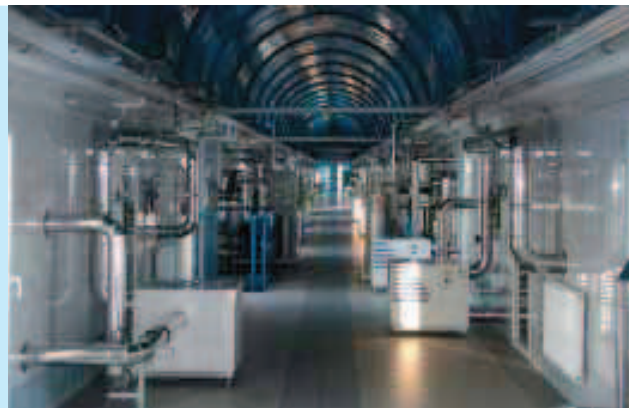
Nowoczesne filtry węglowe w Zakładzie Uzdatniania Wody w Goczałkowicach.
