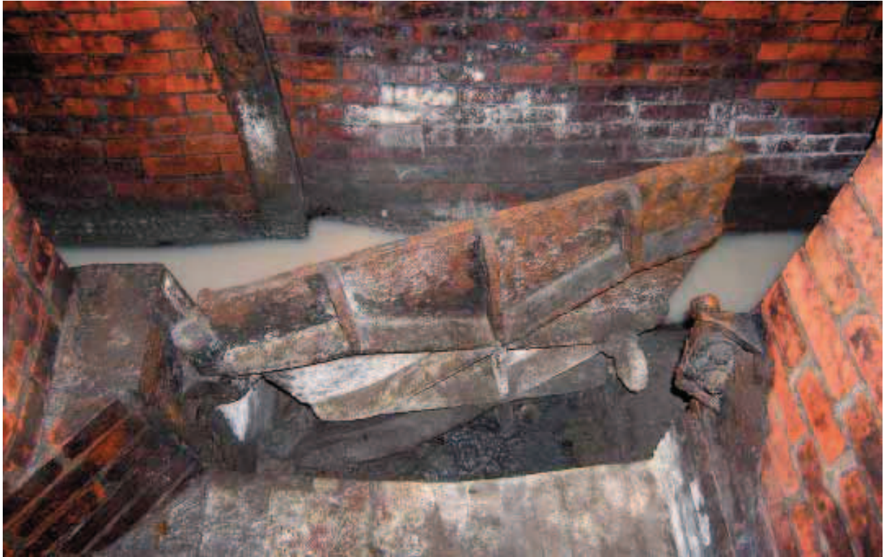
Łódź. Drzwi kanałowe w kolektorze ogólnospławnym, Łódź (foto ZWiK Łódź)
