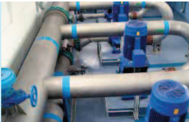
Zespół pomp wody uzdatnionej do sieci wodociągowej.
