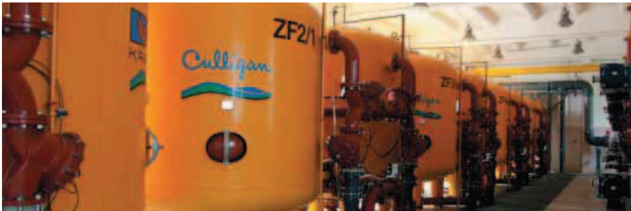
Zespół filtrów ciśnieniowych pospiesznych KREVOX – Culligan (typ HF 9) w stacji uzdatniania wody.
