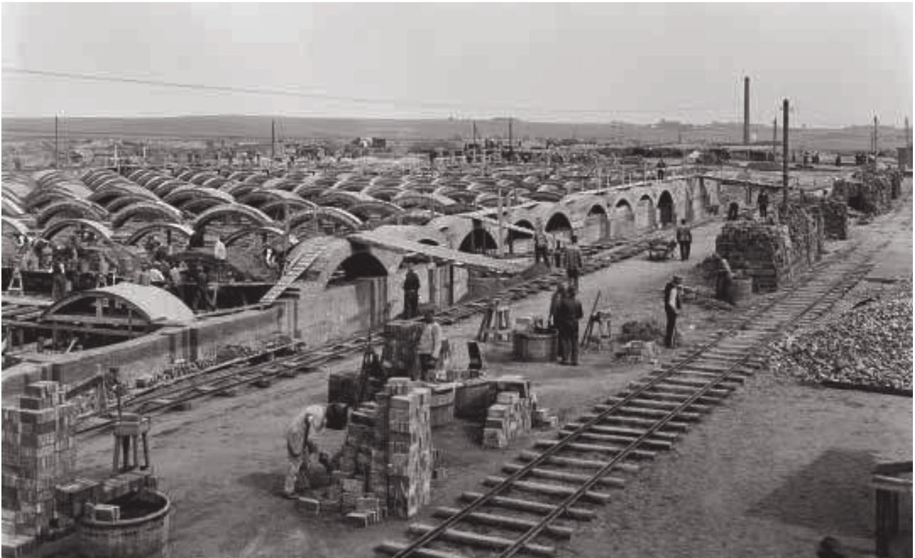
Budowa zbiorników wody w Łodzi. 1935-1937 r. Zaprojektował je na początku XX wieku William Heerlein Lindley. W jednym z wyższych miejsc miasta – 260 m n.p.m. – powstały rezerwuary wody, pełniące rolę gigantycznej wieży ciśnień. Zostały zbudowane na planie czterech kwadratów o boku 60 metrów każdy, ze specjalnie wypalanej cegły, ze ścianami w kształcie łuków, by zmniejszyć ciśnienie zgromadzonej w nich wody. Rozbudowane po II wojnie światowej łódzkie zbiorniki mieszczą 100 tys. m 3 wody (arch. ZWiK Łódź)
