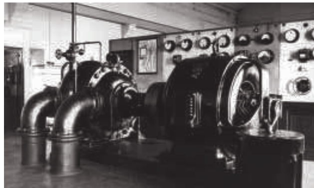
[70] Pompa wody czystej – Wnętrze Maszynowni (teraz Pompowni Wody Czystej) 1943-1945 r. (arch. Aquanet SA)
