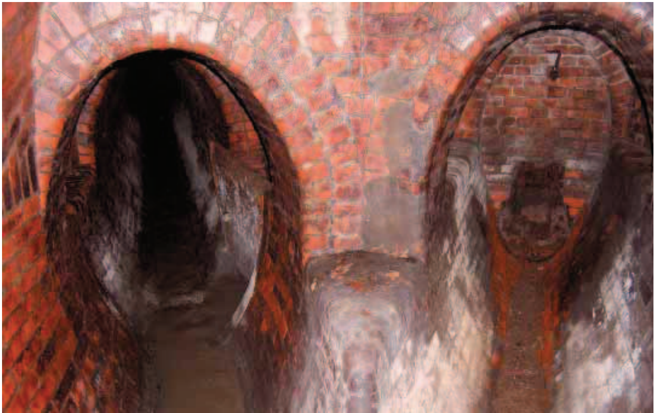
Łódź. Połączenie kanału ogólnospławnego z kolektorem w komorze pod „gwiazdą” (foto ZWiK Łódź)
