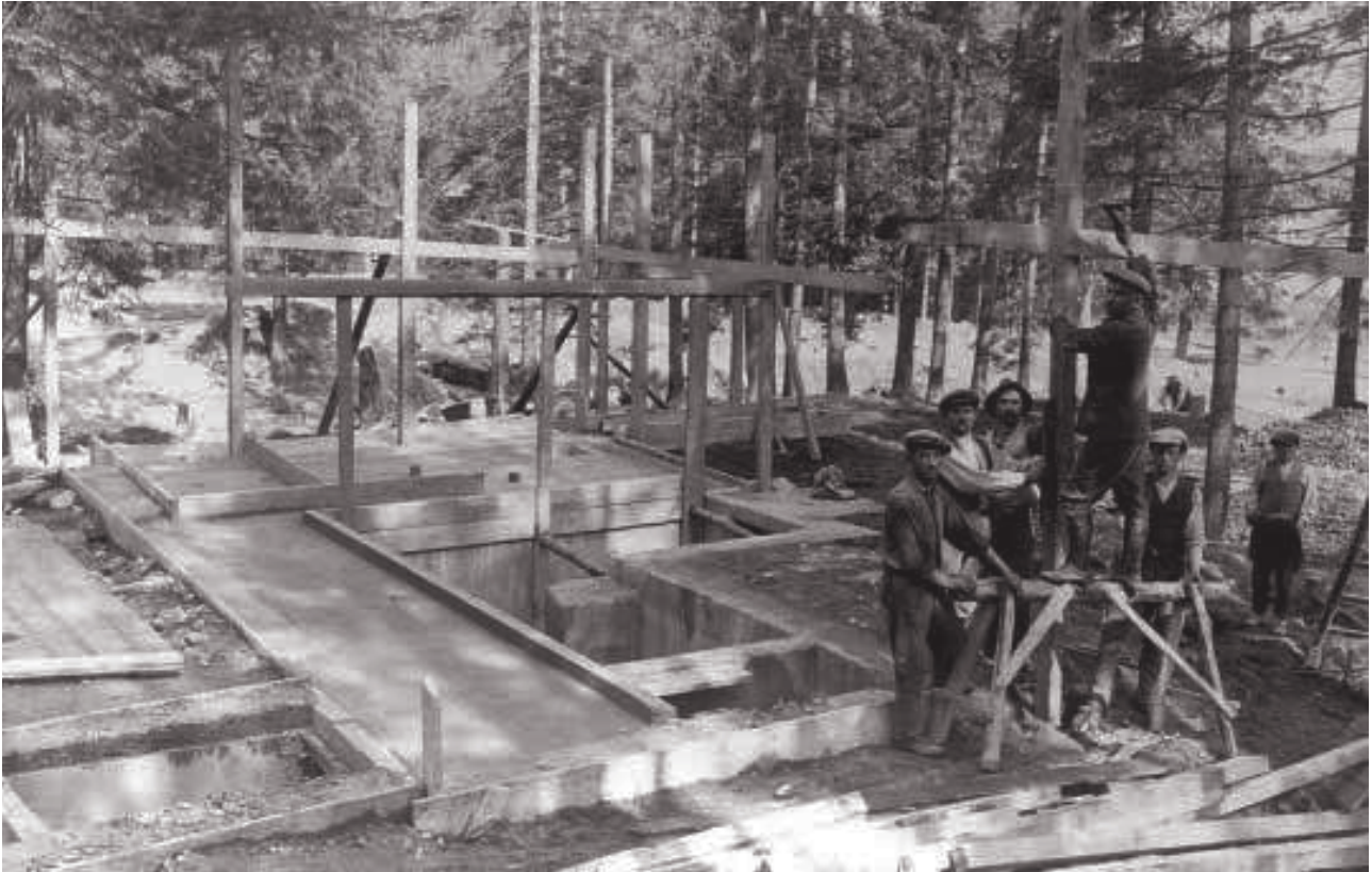
Zakopane, woj. małopolskie – ujęcie w Dolinie Jaworzynki – komory uzbrojeń – foto H. Schabenbeck – 1929 r. (arch. WBZM)
