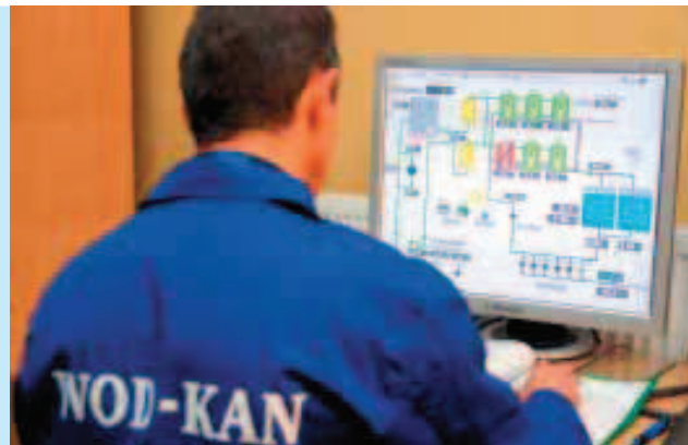
Monitorowanie procesów uzdatniania wody – Biała Podlaska.
